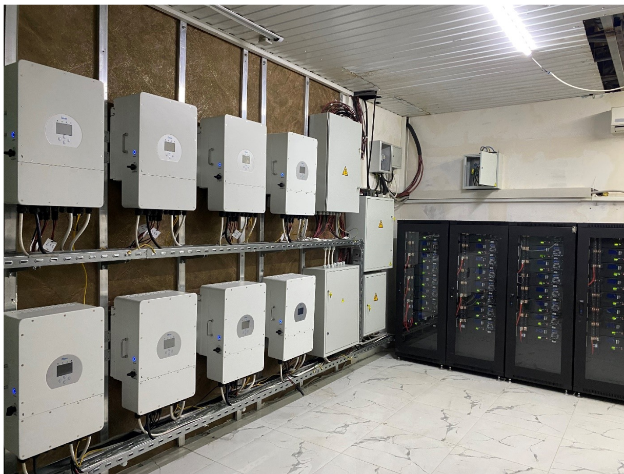
Гибридные солнечные инверторы Deye с суммарной мощностью 96 кВт.
